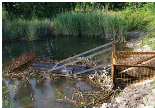
Obrázek 25 Ochrana propustku představenou ocelovou klecí na nátoku. Zajištění průtoku je posíleno vložením dvou plastových trub vytažených vysoko nad vtok do propustku. Jejich nátok je rovněž chráněn ochranným drátěným košem.
