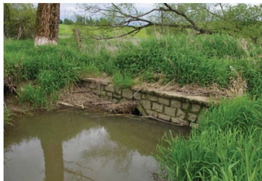
Obrázek 24: Částečně ucpaný propustek nežádoucí aktivitou bobra.
